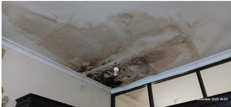
Kondisi Sebelum Pemeliharaan atap
