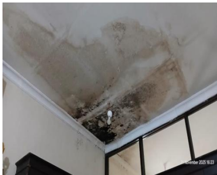
Kondisi Sebelum Pemeliharaan atap
